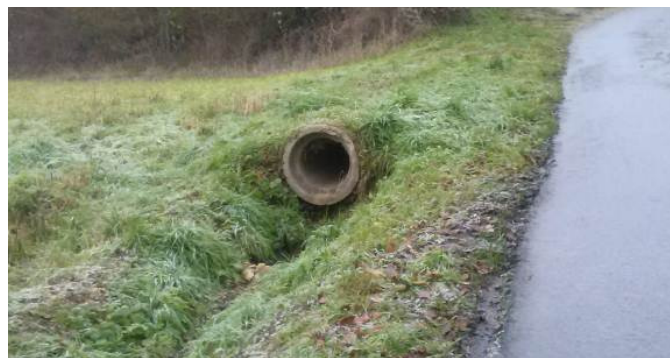
Figure 4 : Collecteur d'eau pluviale le long d'une route communale de Septeuil
